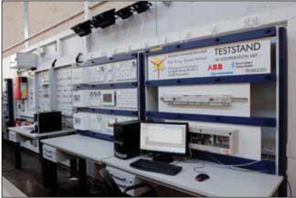
Am KNX Testplatz können die Studenten – ähnlich wie in einem Wohnhaus – Funktionen mit der ETS parametrieren und testen
