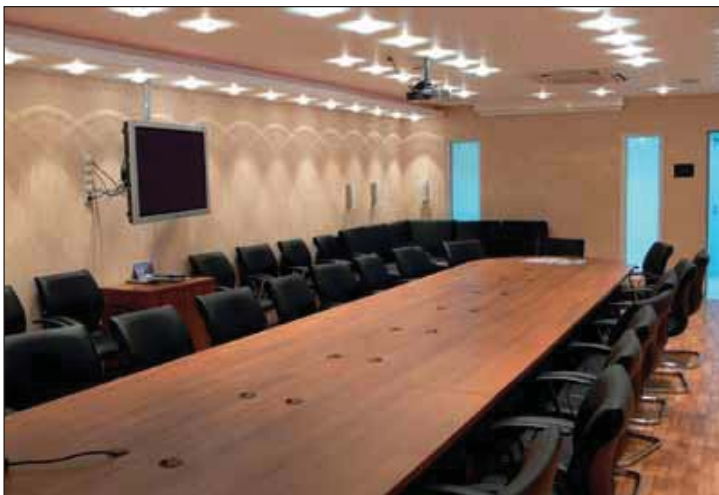
Im Sitzungssaal werden intelligente Funktionen der KNX Gebäudeautomation gezeigt
