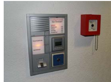
Bild 2. Dank der Vernetzung der Gewerke werden bei der Zutrittskontrolle per Fingerprint die Tore geöffnet sowie die Beleuchtung eingeschaltet. Quelle: HTL St Pölten
