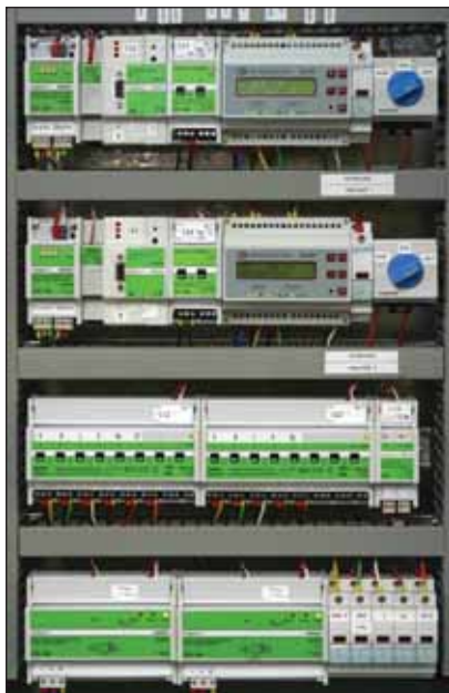
Bild 3. KNX Komponenten im Messraum Dachgeschoss
