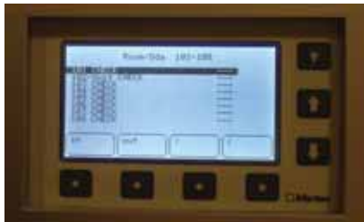
Bild 2. Von der Rezeption aus kann die Klimaanlage jedes Zimmers über KNX bedient werden.
