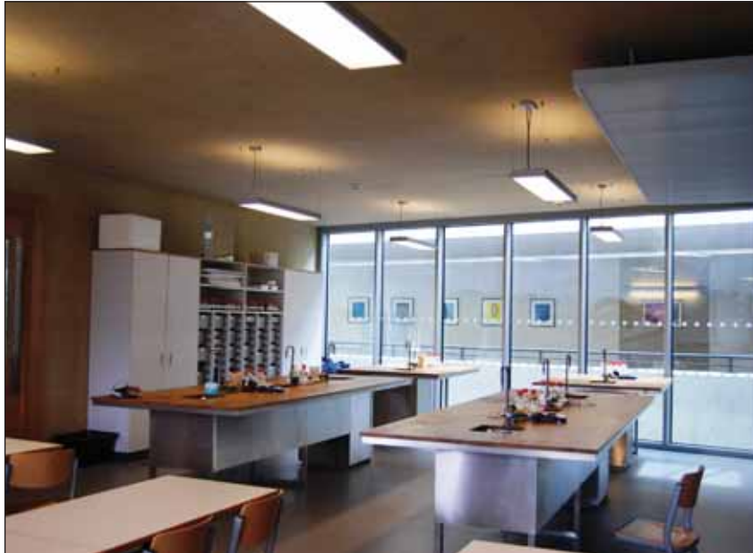
Bild 1. Energieeffizienz 1: Konstantlichtregulierung durch KNX in den Labors.
