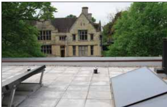
Bild 3. Nachhaltige Ressourcen: Solarkollektoren für das Brauchwarmwasser.
