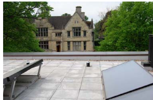
Bild 4. Nachhaltige Ressourcen: Solarkollektoren für das Brauchwarmwasser. Quelle: Andromeda
