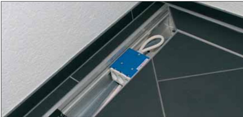
Bild 2. Bodenkanäle ermöglichen jederzeit das Nachrüsten von Anschlüssen
